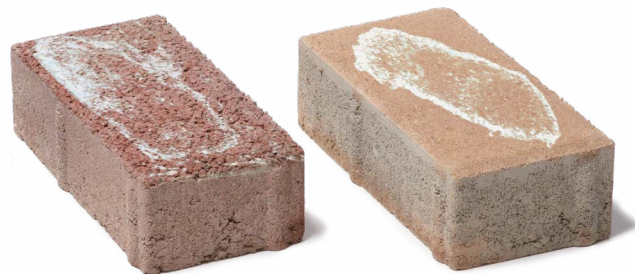
Dlažba s výkvětem
