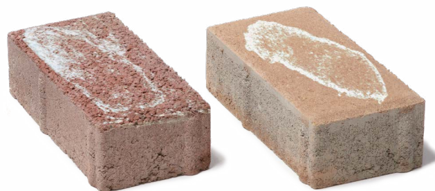
Dlažba s výkvětem
