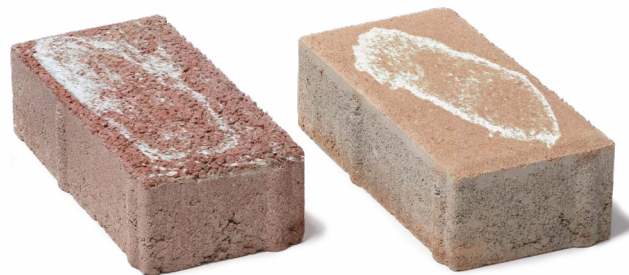
Dlažba s výkvětem
