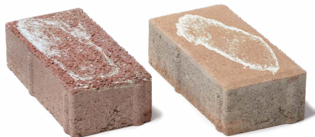
Dlažba s výkvětem
